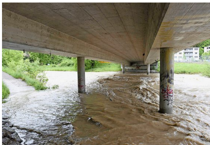
Töss-Hochwasser an der Schlachthofstrasse: Aufgrund der zu erwartenden Niederschläge ist damit zu rechnen, dass die Töss erneut Hochwasser führen wird. Archivfoto: Heinz Diener
